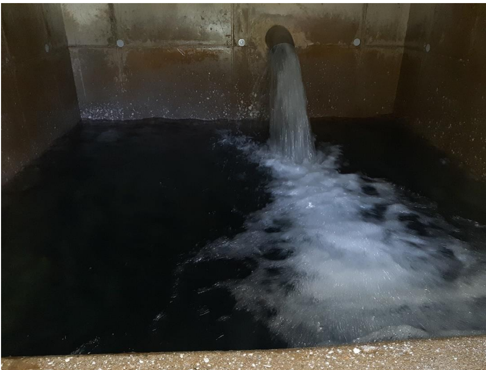
Abb. 3: Blick in die Wasserkammer des US Wasserschloss mit dem Zulaufrohr an der Rückwand
