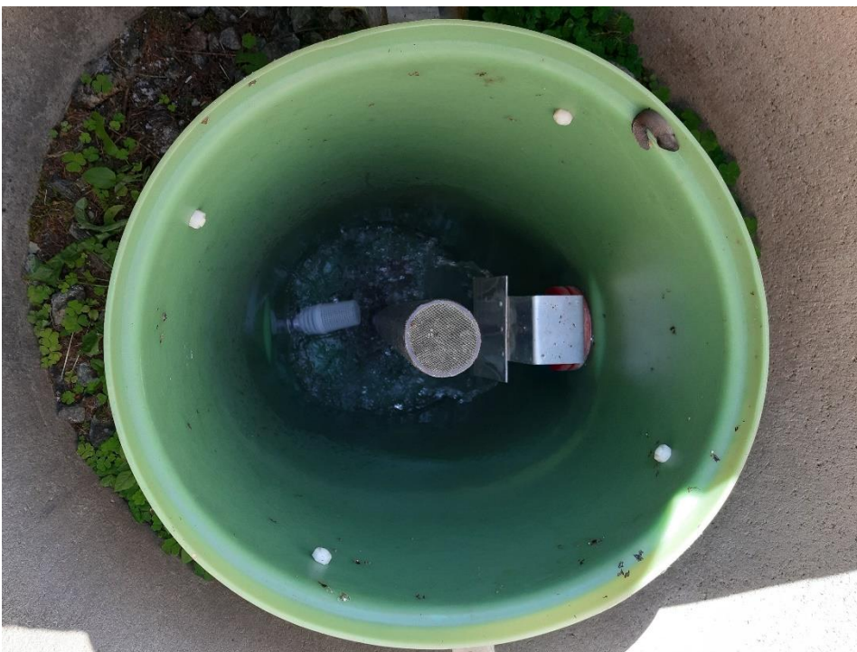
Abb. 2: Blick in den Quellschacht der Michelbacherquelle (gut ersichtlich die Verunreinigungen an der Schachtwand sowie eine eingedrungene Schnecke)
